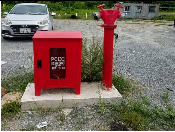
Công trình PCCC
