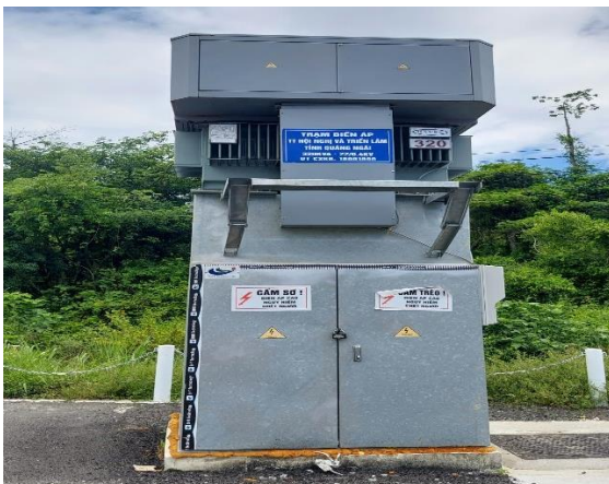
Trạm biến áp
